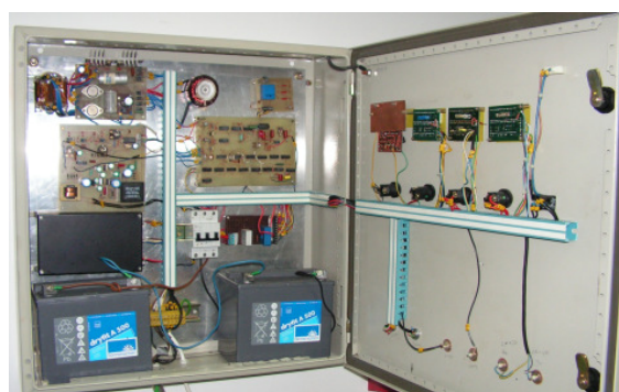
Rys. 10. Szafka ze sterownikiem silnika i bateriami zasilającymi
