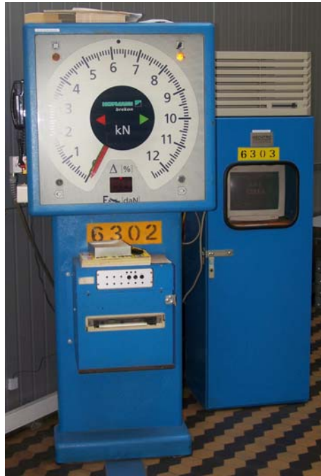
Rys. 1. Widok ogólny szafy sterującej stanowiska rolkowego
